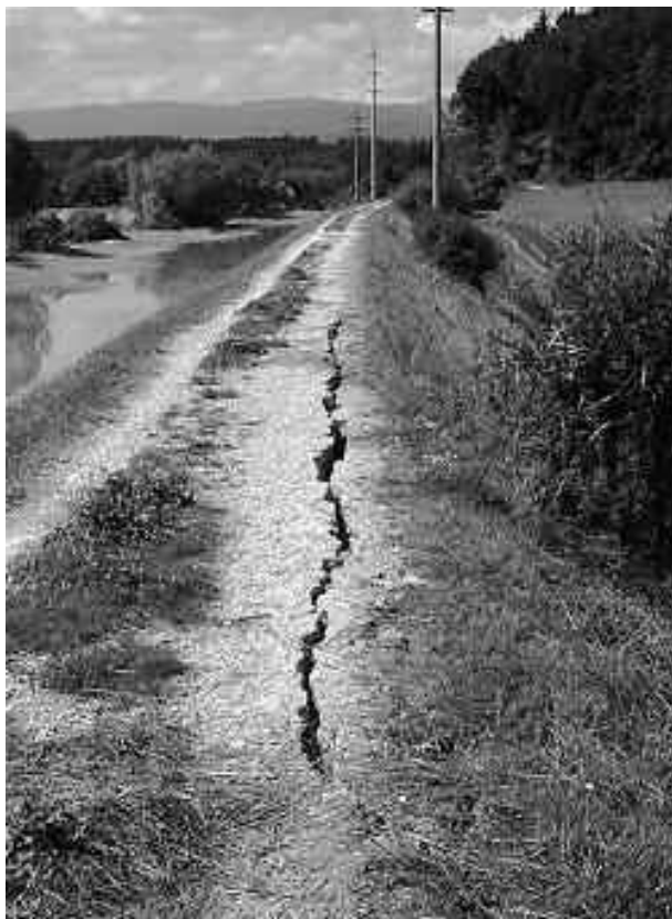
Hagneckkanal 23. August: Im rechten Dammkörper bildeten sich bis zu 50 m lange Risse. Lange hätte der Kanal dem hohen Wasserdruck nicht mehr Stand halten können. Le canal de Hagneck le 23 août 2005. La digue présente des fissures allant jusqu'à 50 m de longueur. Elle n'aurait pas pu retenir encore longtemps une telle pression.
